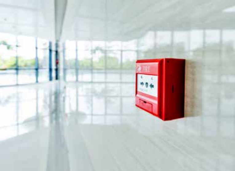
Feuermelder sind wesentliche Bestandteile einer Brandschutzanlage
