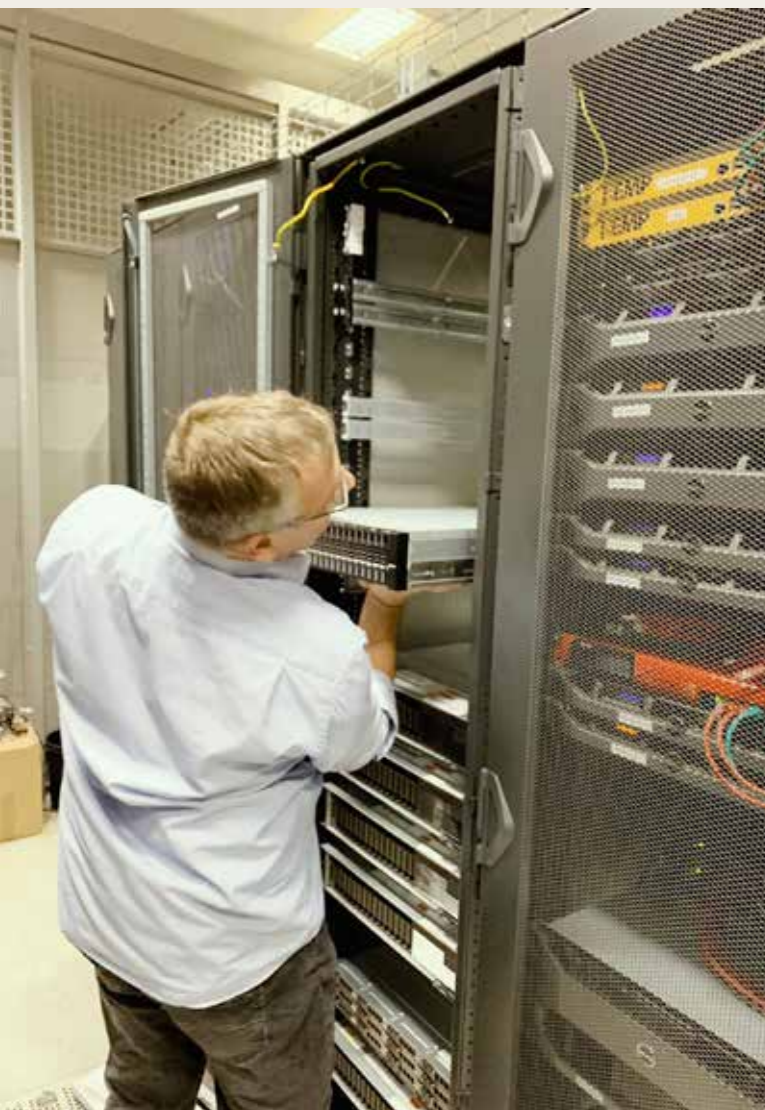
Sicherer als im Keller: IT-Chef Walla bestückt den frisch gemieteten Serverschrank im Rechenzentrum
